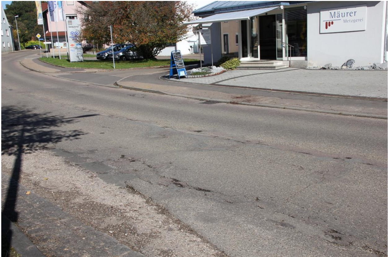
Schlechter Ausbauzustand / Gestaltungsmängel im öffentlichen Raum
